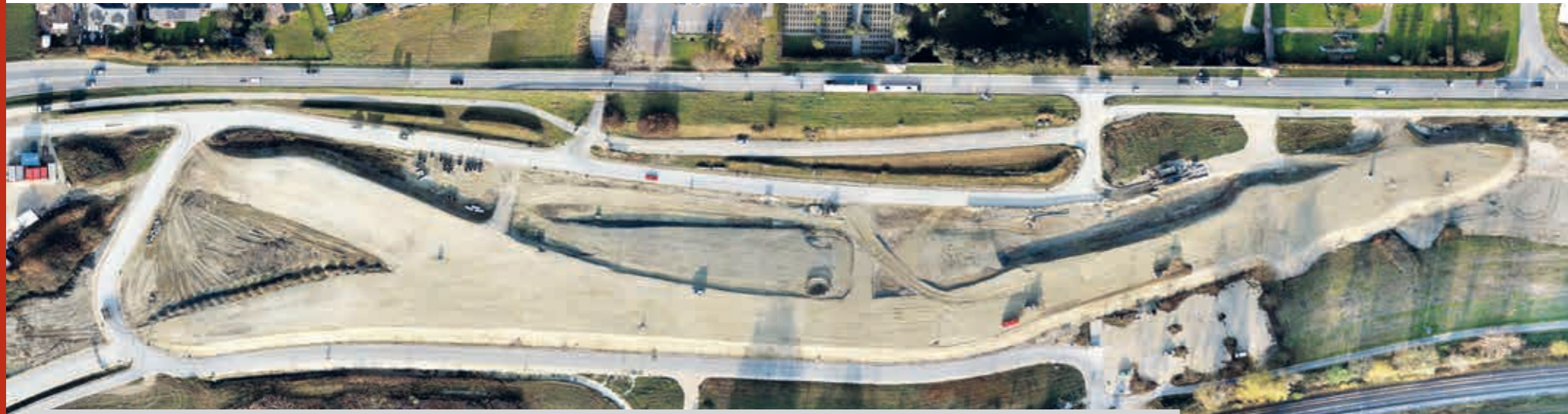
Der aufgeschüttete Damm vor den Mauern des Klosters Hegne. Aus der Luft gesehen hat er fast die Form des Bodensees. Zwischen ihm und dem Kloster soll später der Tunnel Hegne entstehen. Die Last des Erdreichs soll zunächst den Boden entwässern helfen.
