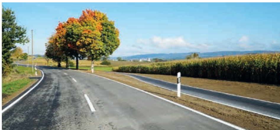
Die sanierte K7760 oder Bugo-Straße verbindet mit dem neuen Geh- u. Radweg Buggensegel und Ahausen.
