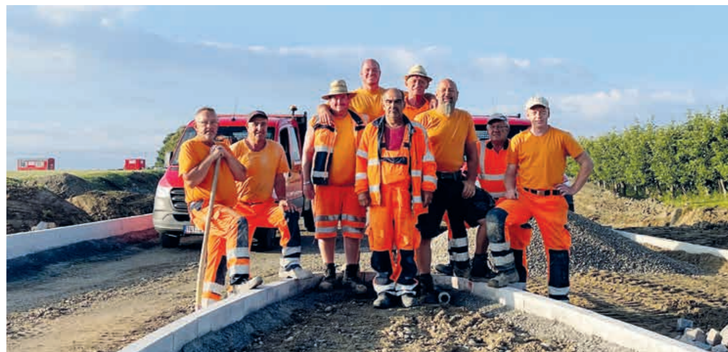
Die Querungshilfe im Bau (v.l.): Wolfgang Klinginger (Facharbeiter), Yakub Bakar (Polier Pflasterbau), Steffen Kohl (Facharbeiter), Alexander Hache (Polier), Klaus Glinka (Facharbeiter), Joachim Moog (Vorarbeiter), Josef Immel, Peter Betko (beide Facharbeiter); Mitte vorn: Thomas Kapp (Polier Trupp 2).
