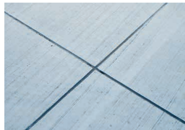
Dehnungsfugen müssen regelmäßig auf Dichtigkeit kontrolliert werden.
