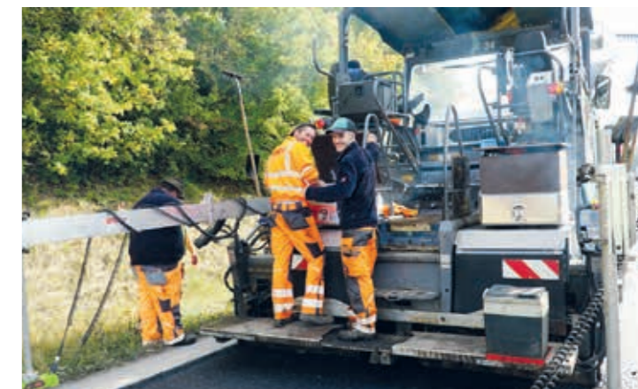
Vergnügt auf dem ersten Asphaltfertiger: Facharbeiter Martin Ott (l.) und Polier Maurice Schlegel.
