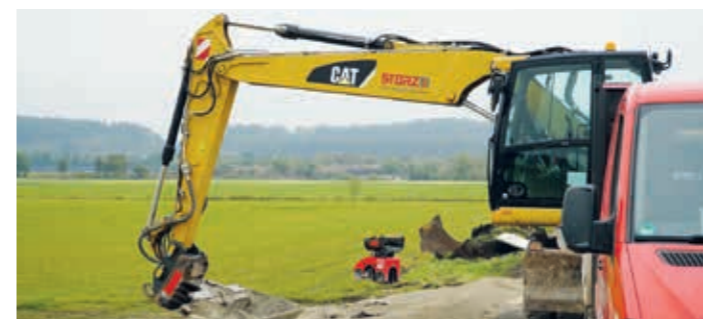
Schon in Sichtweite: der Zielpunkt der Leitungen. Am bisherigen Wasserwerk „Schabelwiesen“ soll ein zusätzliches Gebäude mit einer zentralen Enthärtungsanlage entstehen.
