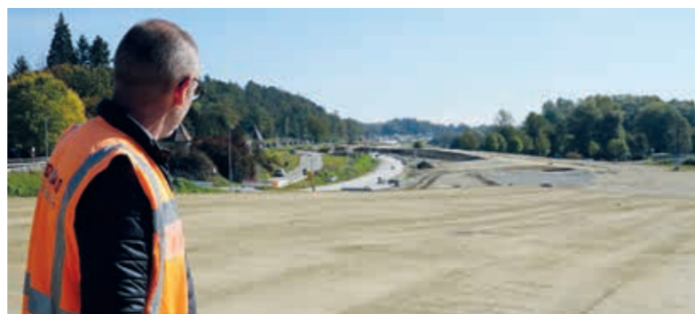
Zwischen der aktuellen Bundesstraße am Kloster Hegne und dem neu aufgeschütteten Damm soll später einmal der Tunnel Hegne entstehen.
