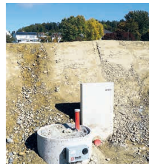
Ein Vertikal- und ein Horizontalinklinometer messen die Bewegungen des Bodens.
