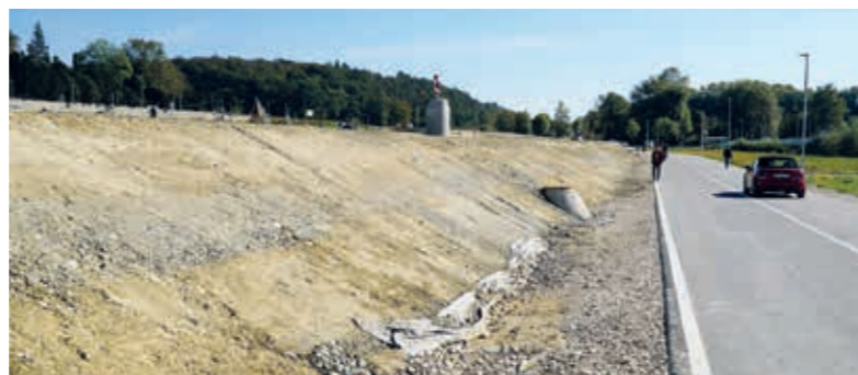
Viele tausend Tonnen Erdreich verursachen Setzungen des Bodens.
