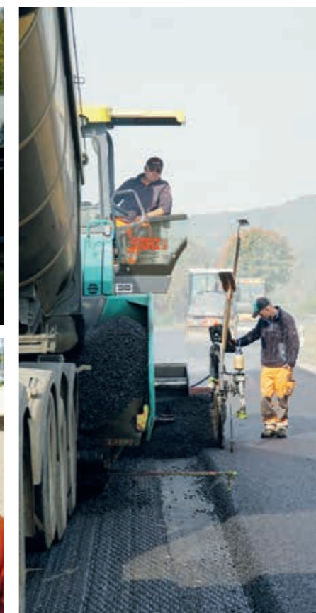
Der zweite Fertiger folgt in kurzem Abstand. Die Asphaltdecke wird „heiß an heiß“ eingebaut.
