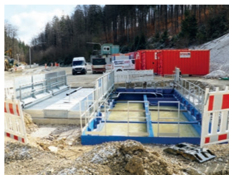
Die Grube für die neue Reifen Waschanlage hoben die Azubis auch ausgegraben.
