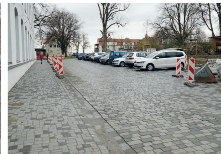
Für Wangen typisches Pflaster baute STORZ auch auf dem ehemaligen Erba-Gelände am südwestlichen Ende der künftigen Landesgartenschau ein.
