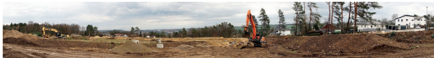
Das Erschließungsgebiet Ergat II in Sigmaringen-Laiz – mit zwei Kettenbaggern bewegen Storzianer hier erhebliche Erdmassen.
