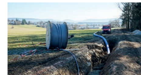
Der bindige Boden und das Tauwetter schwächen die Grabenränder und erschweren die Arbeit.
