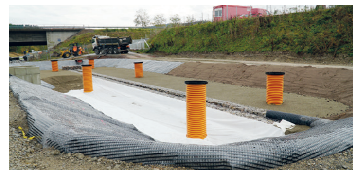
Hier wird der mehrschichtige Aufbau der Anlage deutlich.
