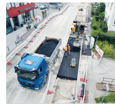
Nach dem Einbau des neuen Kanals wird die Baugrube wieder fachgerecht verschlossen.
