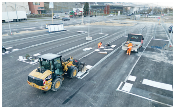
Der provisorische Busbahnhof in Tuttlingen - Facharbeiter Manuel Perez und Maschinist Nikolei Kenzler erledigen Ende November Restarbeiten.
