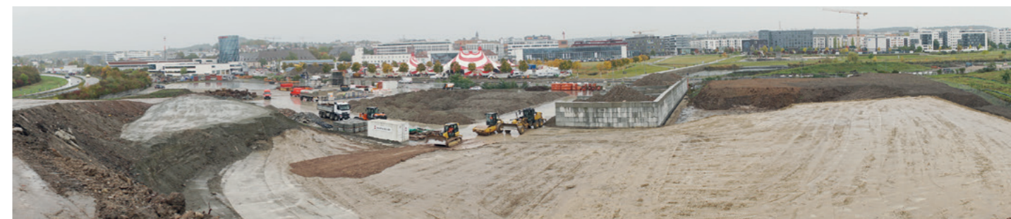
Blick vom Haufwerk auf dem Gelände des ehemaligen Böblinger Flugfeldes. Hier werden mehrere hunderttausend Kubikmeter Boden zwischengelagert.
