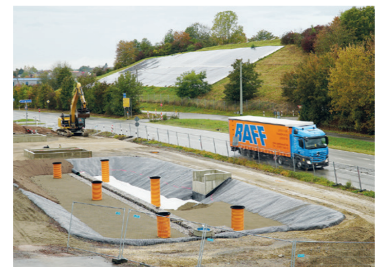
In diesem Becken wird das Niederschlagswasser gesäubert, bevor es in die Kanalisation gelangt.
