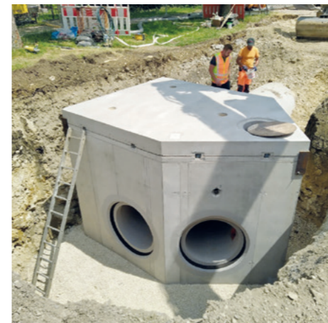
38 to wiegt dieses Vereinigungsbauwerk. Von hier zweigen die Kanäle und die Stauräume ab.
