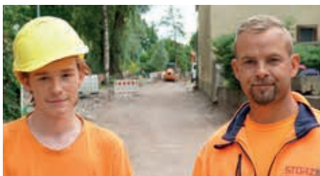
Die Jüngeren auf dieser Baustelle: Polier Sebastian Fritsche (r.) und Azubi Jason Lütte.
