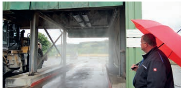
Geruchsneutralisation durch Vernebelung – über solche Anlagen verfügen in Deutschland nur ganz wenige Asphaltmischwerke.
