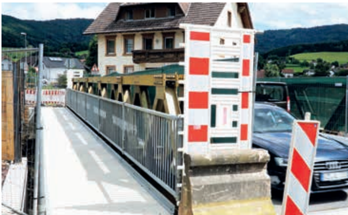
Von der Behelfsbrücke aus hat man einen hervorragenden Blick auf die laufenden Bauarbeiten.
