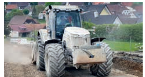
Bis zu einem halben Meter tief wird das Erdreich gefräst, bevor hydraulische Bindemittel zugesetzt werden.
