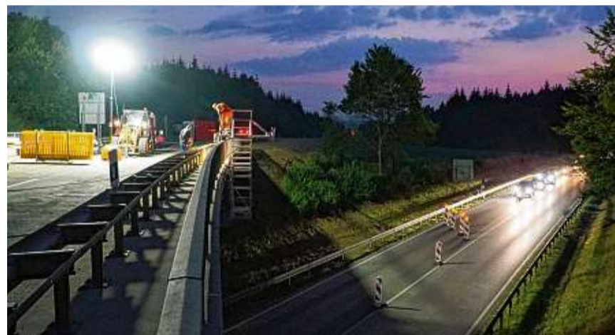
Brückenarbeiten an der B 523 bei Tuningen: Damit der Verkehr nicht allzu sehr behindert wird, müssen wichtige Arbeiten nachts ausgeführt werden. BILD: JOACHIM MAHRHOLDT
