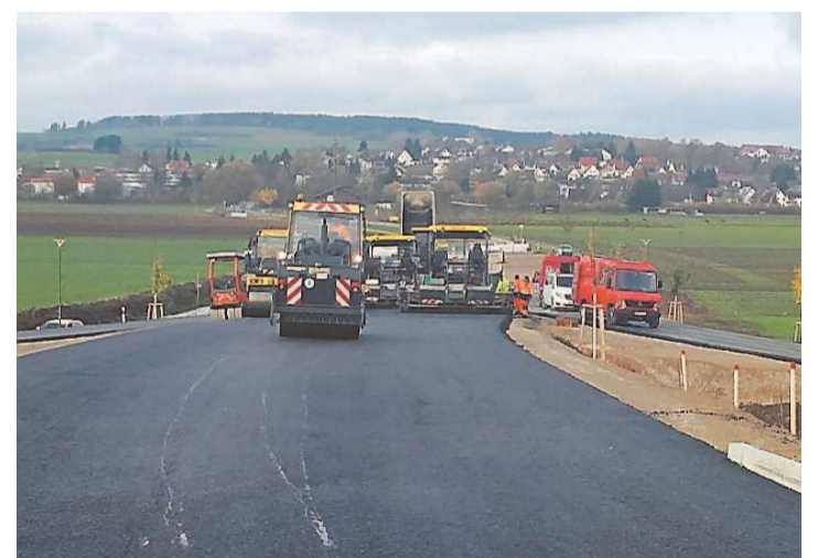
Arbeiten am Zubringer Allmendshofen der B 27: In drei Schichten bringen die Straßenbauer aus Tuttlingen die Fahrbahndecken auf. In einem Monat soll der Verkehr wieder normal rollen. Foto: Privat
